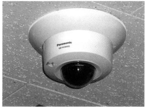
図3.5 監視用カメラ
