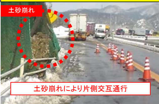
国道21号の土砂崩れの状況
